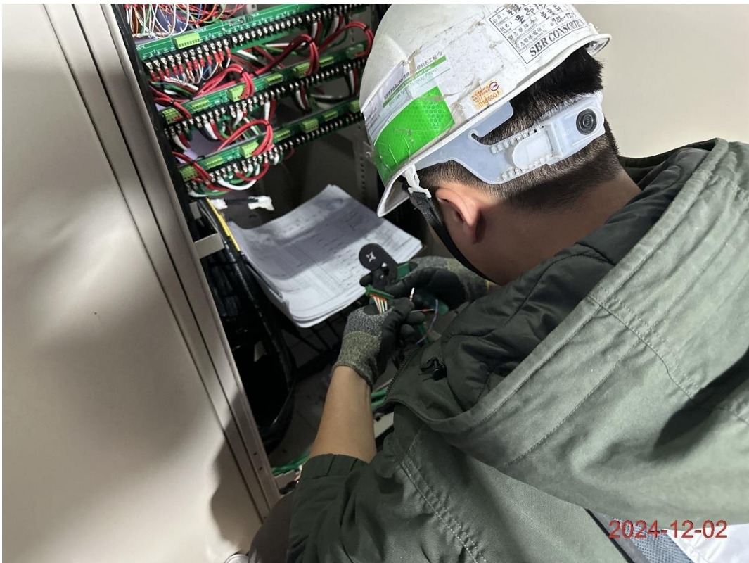
G14 站通訊系統機櫃設備結線
