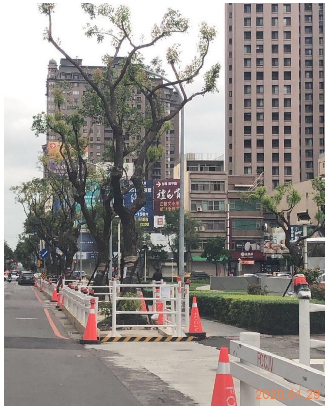
中正路路樹及地上設施遷移、人行道削減及中央分隔島敲除
