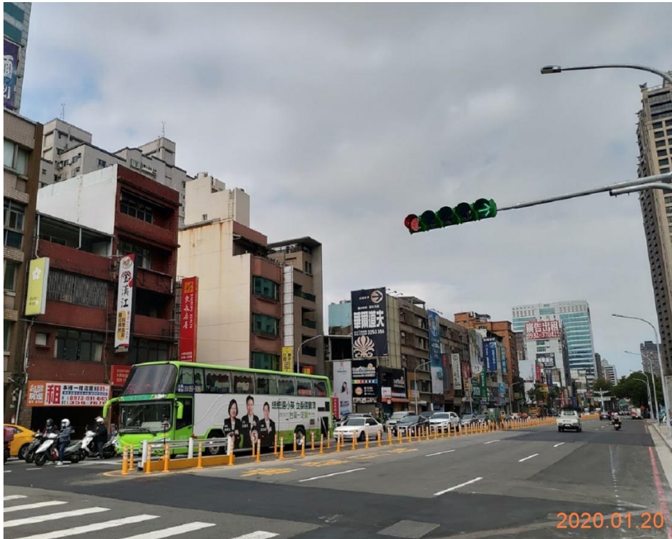
中正路路樹及地上設施遷移、人行道削減及中央分隔島敲除
