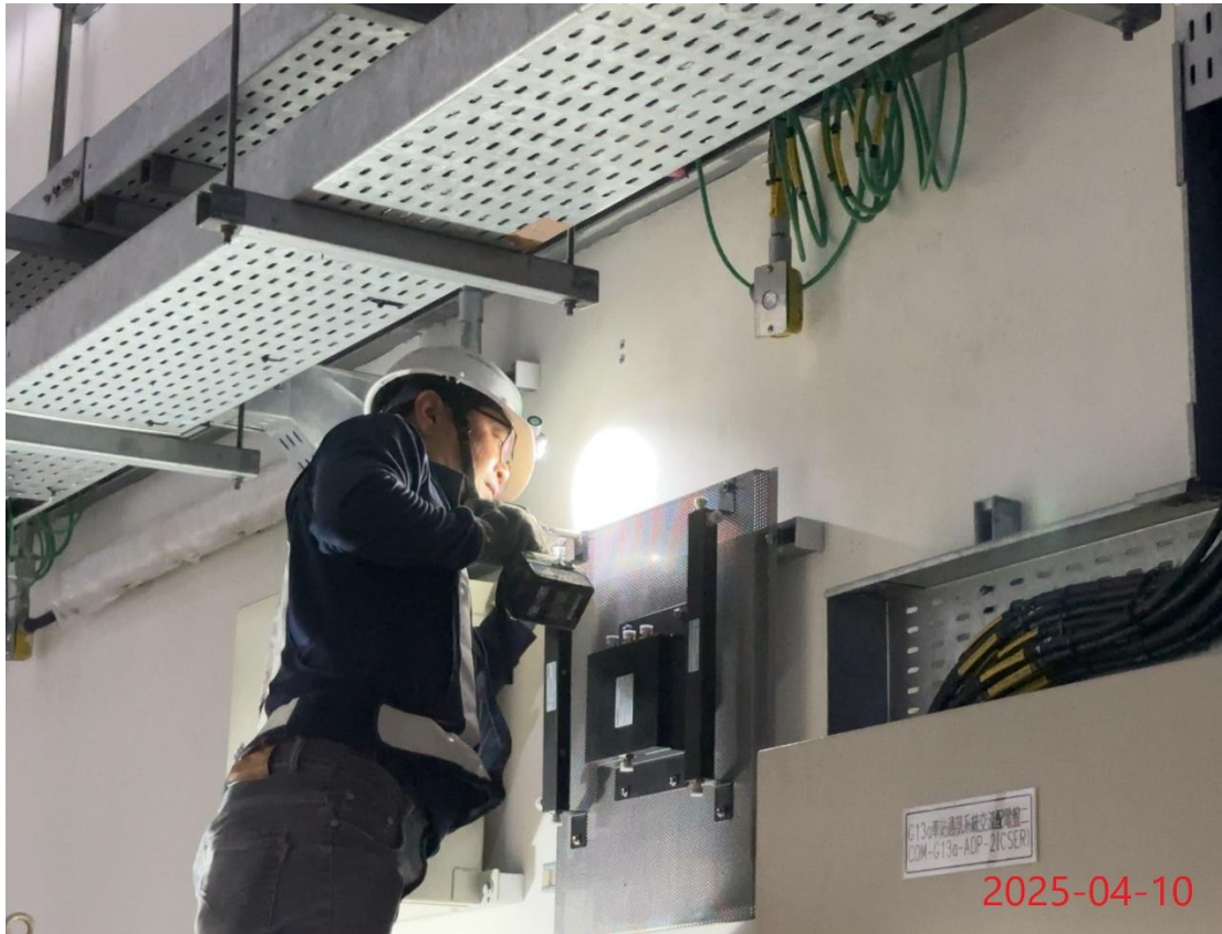
G14 站通訊系統無線電放大器安裝
