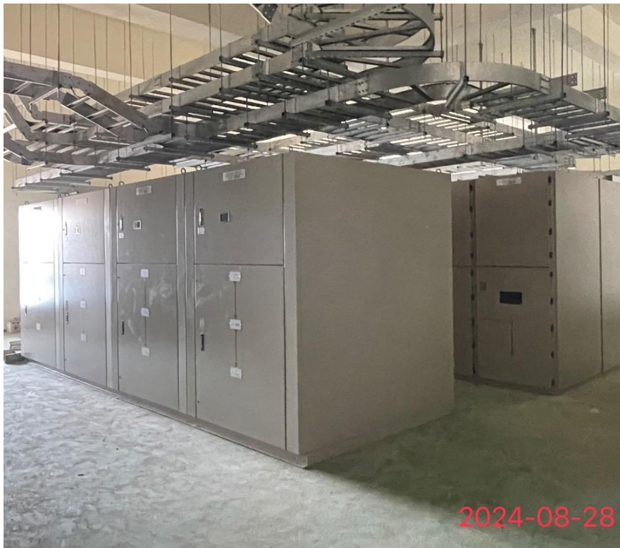
22kV 開關箱定位
