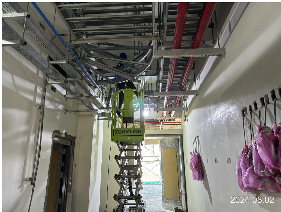
G32 站 5F 消防及撒水幹管配管
