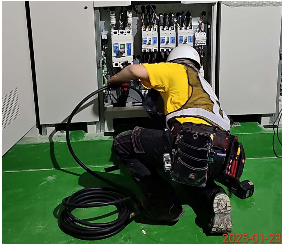
北機廠管理中心 UPS 盤內結線
